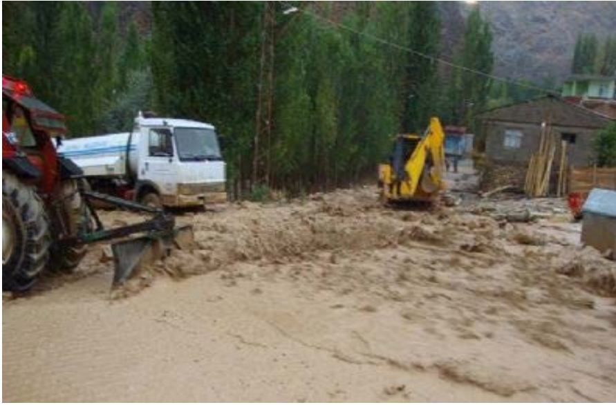
Fotoğraf 3: Ayvalı Kasabasında 2010 Yılında Görülen sel olayında yerleşim yerleri ve tarım alanları ciddi zarar görmüştür.
