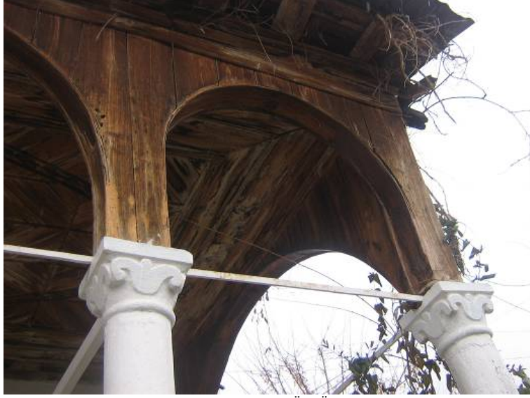
Fotoğraf 4: Havuzbaşı Üst Örtüye Geçiş
